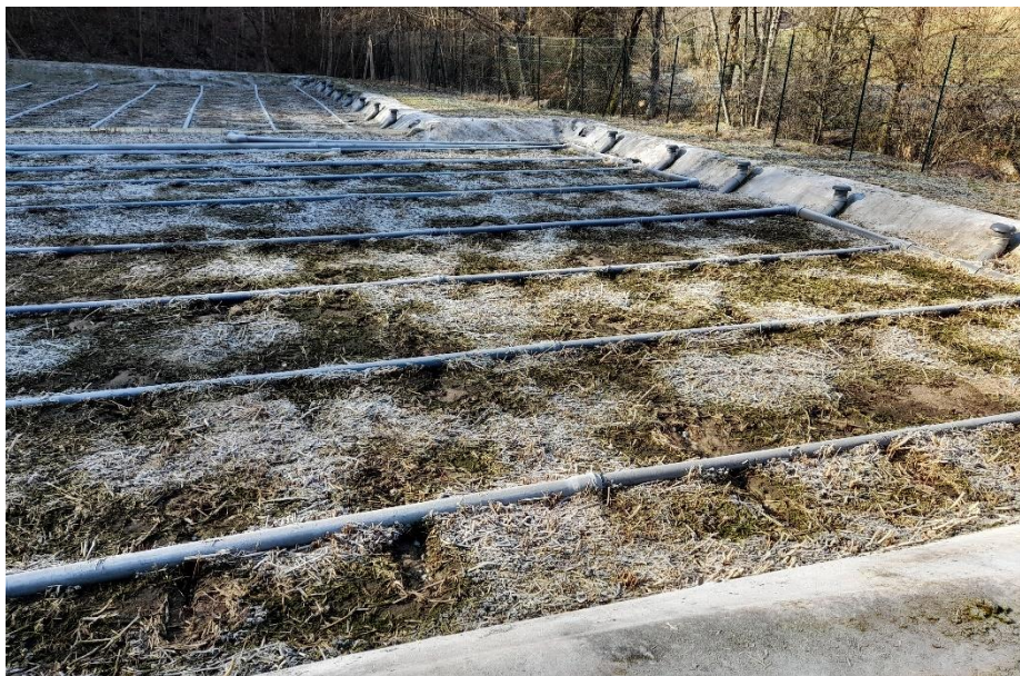
2 nd étage du filtre planté de roseaux
