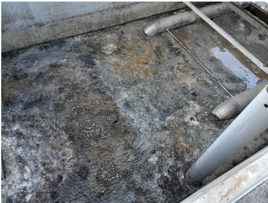
Système de chasse non fonctionnel et encrassé
