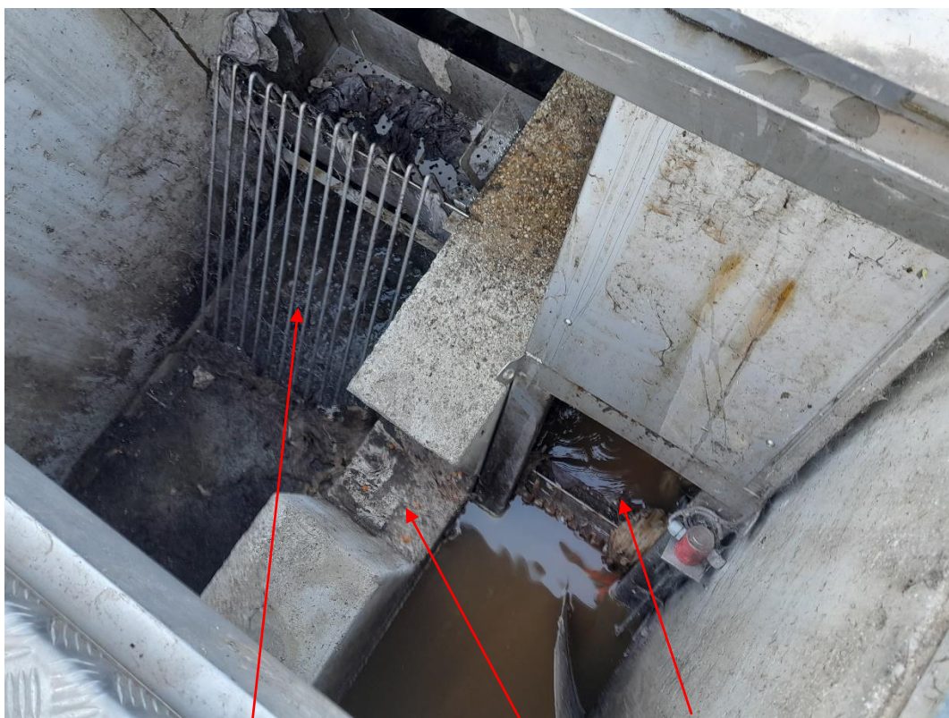
Dégrilleur manuel de by-pass / by-pass / dégrilleur automatique
